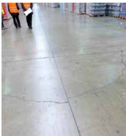
Foto 4, 5 Curling, imbarcamento delle lastre dovuto ad una scarsa stagionatura
