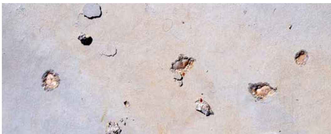
Foto 16 Degrado da reazione ASR
