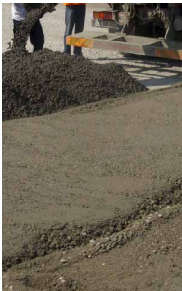
FIGURA 38 Stese di misto cementato realizzate con l'impiego di Cenere Volante MICRO-POZZ PFA
