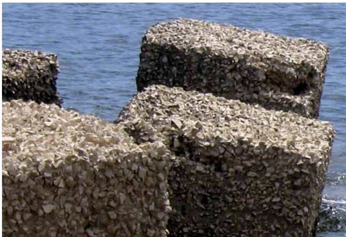
FIGURA 30 L'acqua di mare contiene elevate concentrazioni di solfati e produce perdita di materiale dalla superficie del calcestruzzo
