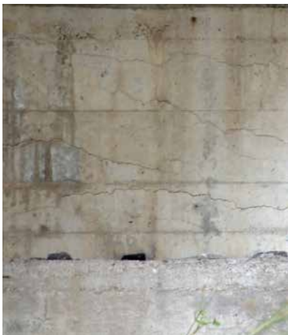
FIGURA 32 Quadro fessurativo di una struttura colpita da reazione ASR
