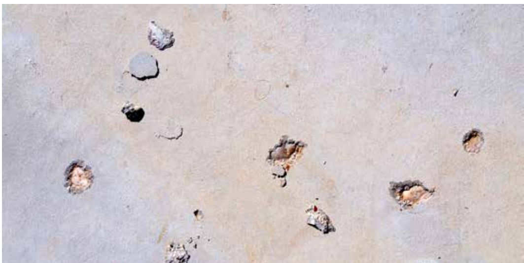
Foto 16 Degrado da reazione ASR
